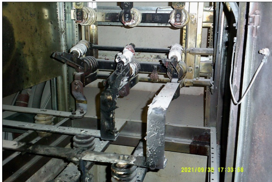
Место несчастного случая. Нижний отсек ячейки ТН и БМРЗ. Оборудование 6 кВ
